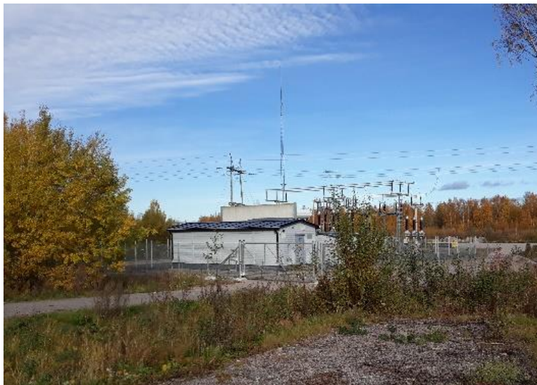
Sähköasema kaava-alueen eteläosassa. Kuva Karhoistentieltä luoteeseen.
