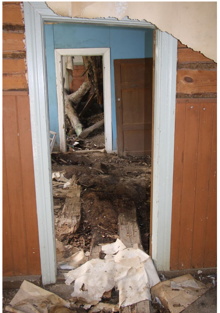
Tutkittu rakennus on purkukuntoinen
