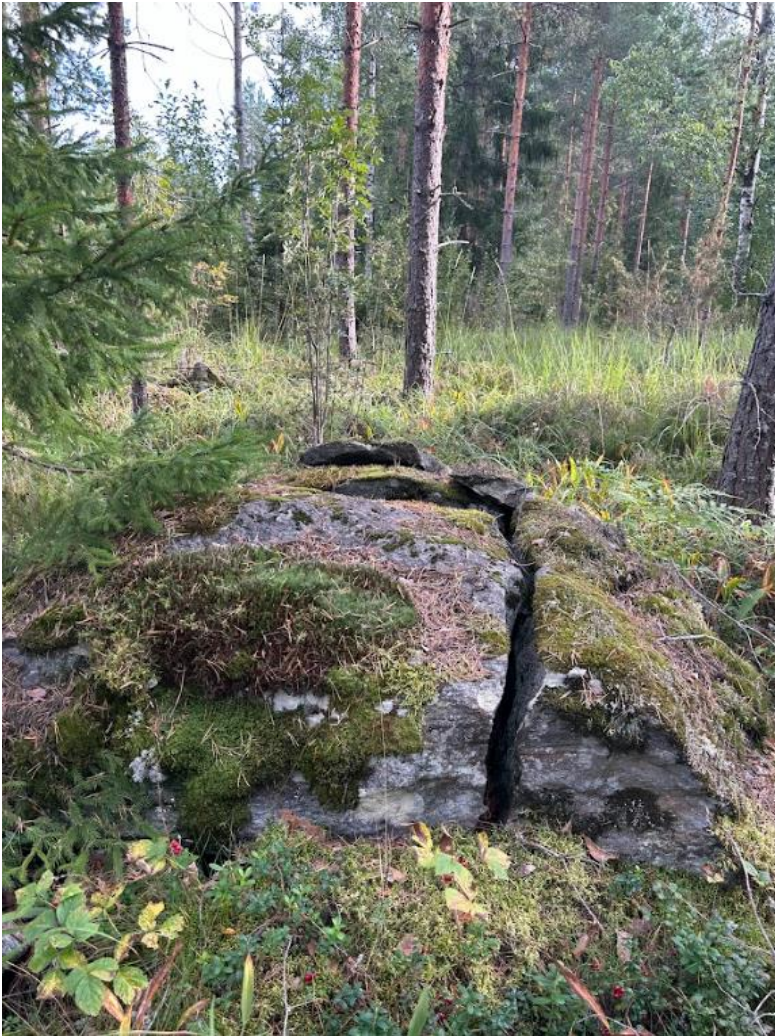
Kuva 19. Pohjaveden tuomasta kosteudesta haljennut kivi
