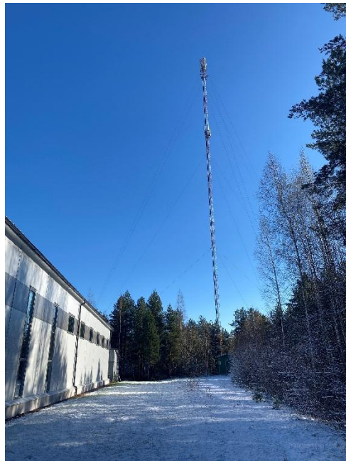
Suunnittelualueella sijaitsee radiomasto ja laitesuoja.
