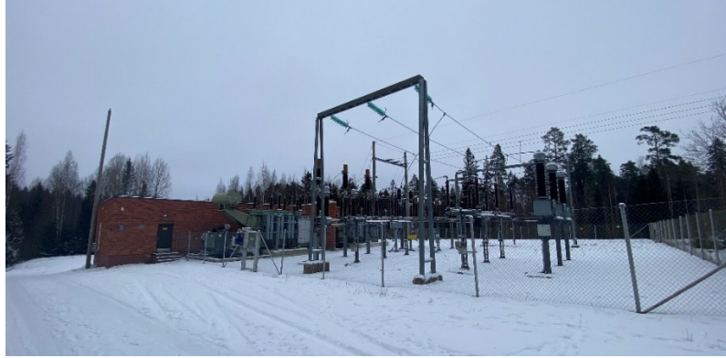
Suunnittelualueella sijaitseva sähköasema.
