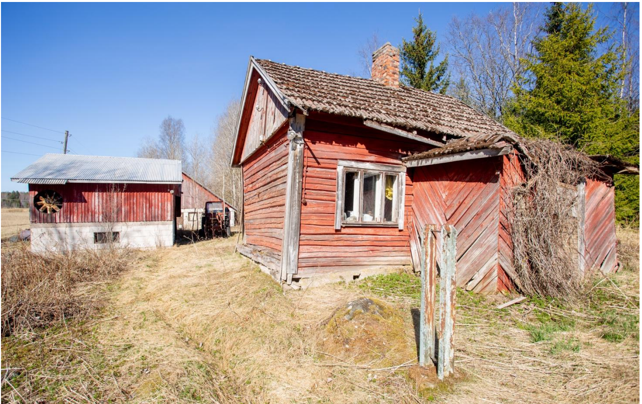
Kuva 29. Pihapiirin vanhin rakennus, mökki. Rakennus on varsin huonokuntoinen. Kuvaussuunta koilliseen.
